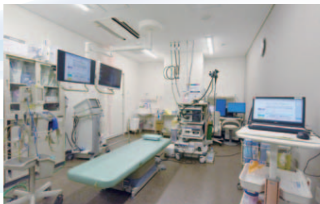
内視鏡検査室（全3ブース+透視室1ブース）
